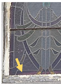
Châssis et mastic en mauvais état
