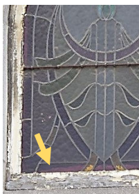
Châssis et mastic en mauvais état
