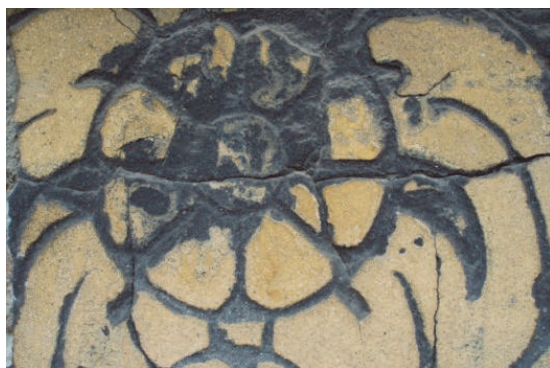
Fissures et craquelures
