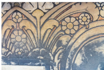
Érosion de l'enduit de surface due aux intempéries
