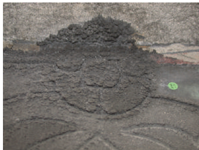
Apparition de croûtes gypseuses
