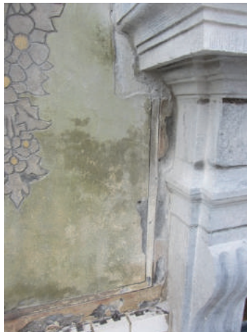
Infiltration d'eau de pluie provenant de la toiture
